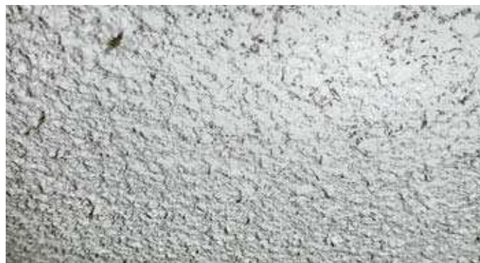
Crépi acoustique amianté
