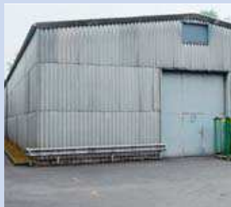
Plaques ondulées amiantées
