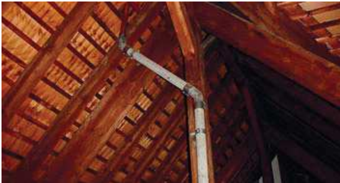
Tuyau d'évacuation d'air
