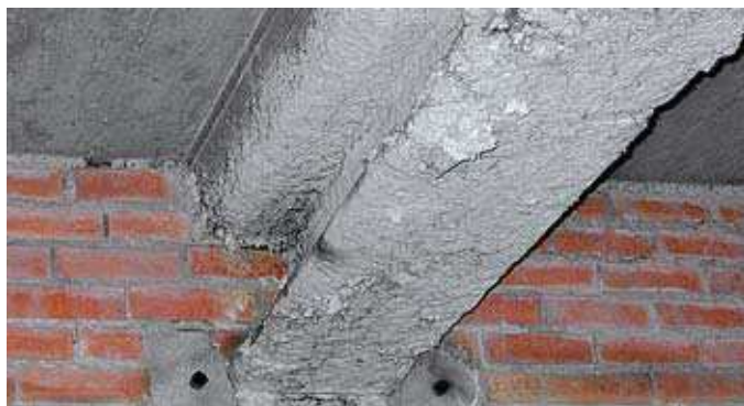
Amiante floqué sur poutre métallique
