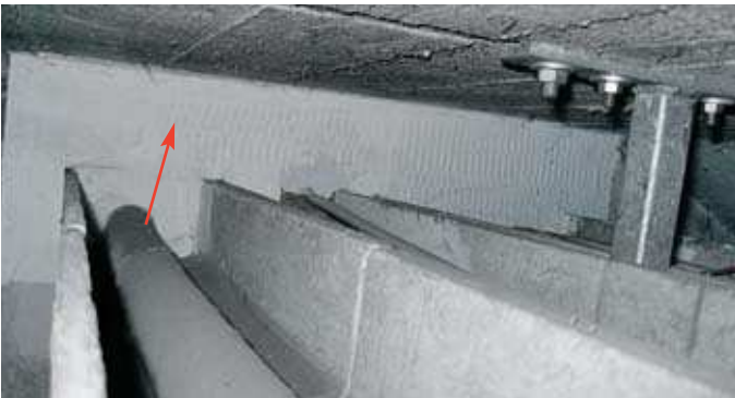
Traversée de câbles avec cloison pare-feu
