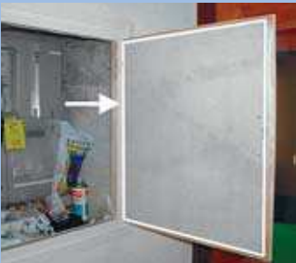
Panneau de protection incendie
