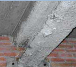
Isolation en amiante floqué
