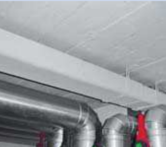
Conduites de câbles en fibrociment
