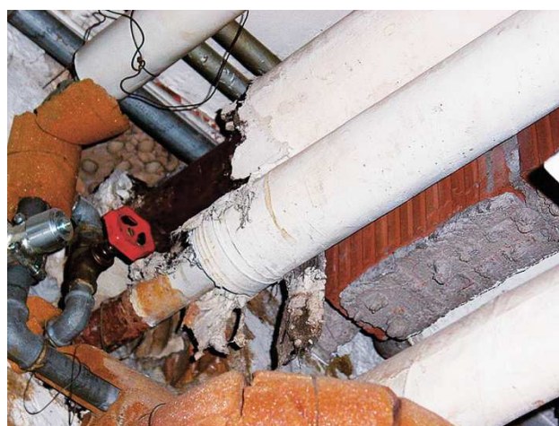
1 Isolation de tuyau avec mortier amianté.
